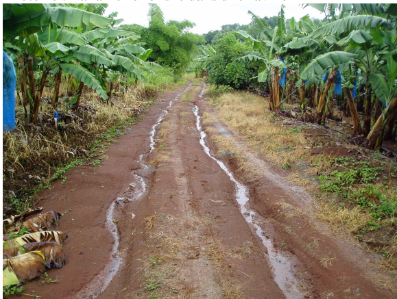
Photo 18 : Trace en terre avec érosion dans les passages de roue
